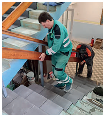
Stavebná čata VPS v zimných mesiacoch pokračovala v postupnej rekonštrukcii interiéru budovy FTC.
